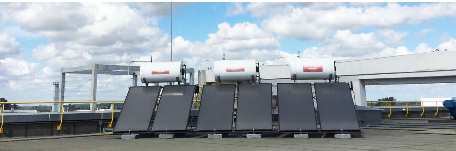
Termopaneles en edificios de Planta Zárate
